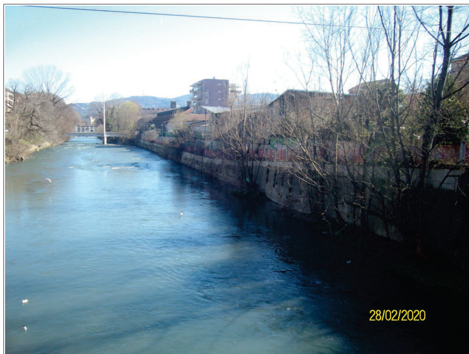
Foto 5. Scattata dal ponte di via Cigna verso valle, si vede il muro che riveste la sponda destra. Sullo sfondo la passerella pedonale che conduce al quartiere Borgo Dora
