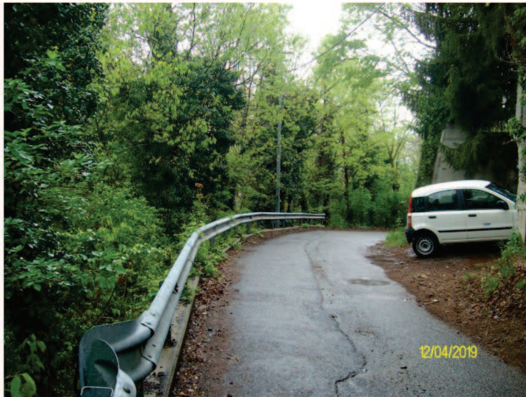
Si vedono ancora i segni del danneggiamento della sede stradale comunale
