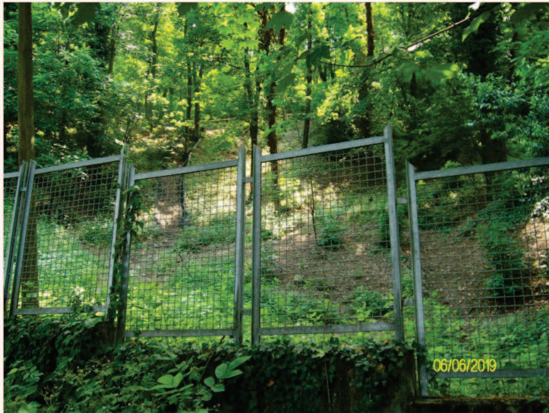
Piede dell'accumulo di frana visto dal cortile di uno dei condomini di corso Q. Sella
