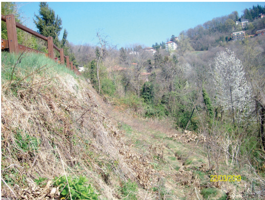
Area in frana con intervento di sostegno a protezione della strada vicinale
