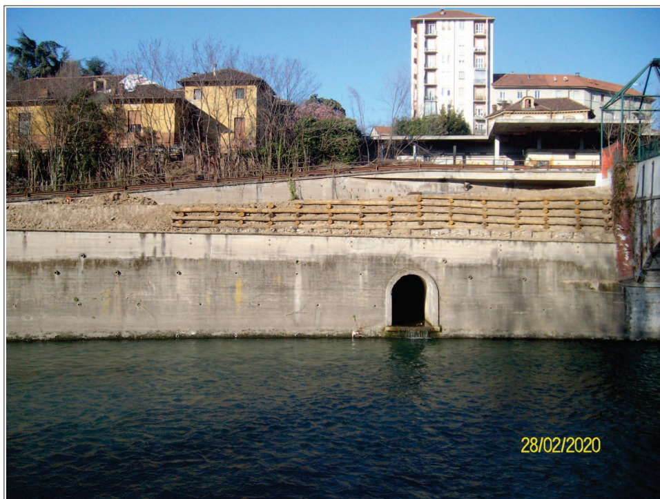
Foto 4. Muro che funge da argine corredato da palificata in legno in sinistra Dora: la foto é scattata dalla sponda destra in corrispondenza del meandro nei dintorni di via Pianezza
