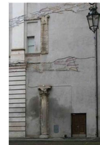
Tracce del loggiato della manica orientale sul prospetto dell'Archivio di Stato www.museotorino.it, Foto di Enrico Lusso
