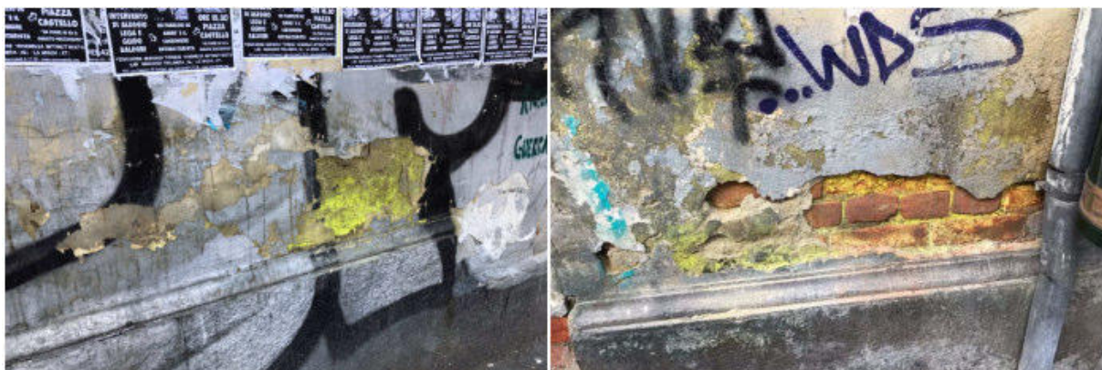
Figura 25: Incrostazioni lato C.so Brescia (sinistra) e Via Aosta (destra)
