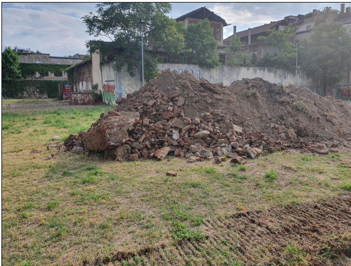
Figura 8 - Blocchi di CLS, manufatti residuali in mattoni e ciottoli decimetrici di origine naturale
