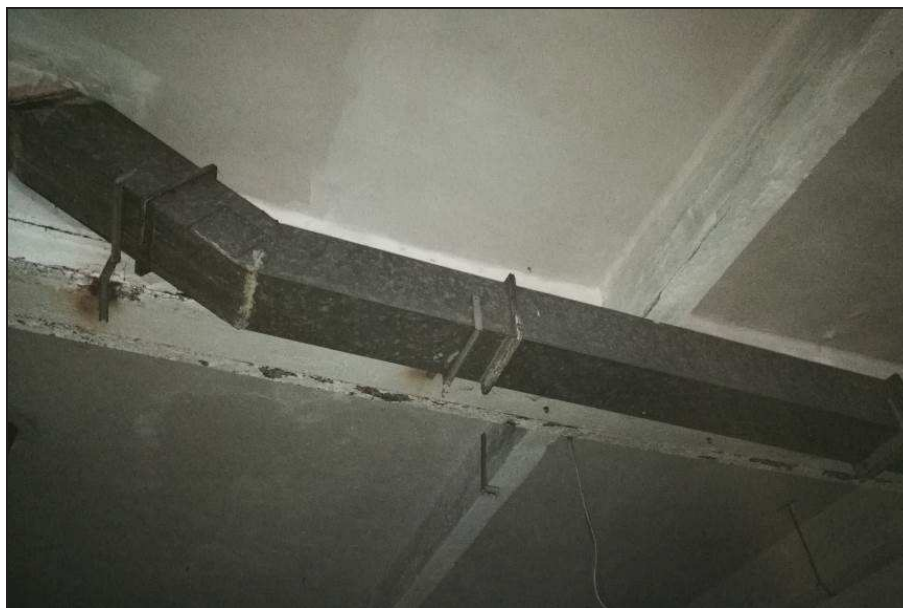
Figura 7 - Particolare condotto con giunti con potenziale presenza di amianto.
