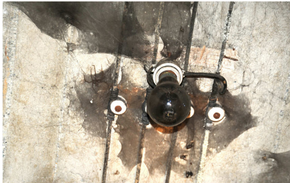
23_ particolare dell'impianto elettrico
