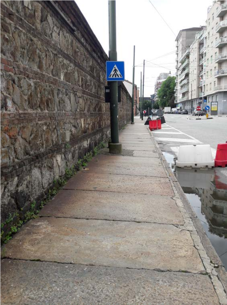
Lotto 7: Il marciapiede in pietra esistente, oggetto di recupero, su via Borsellino, lato est, antistante le nuove aule Politecnico-OGR.
