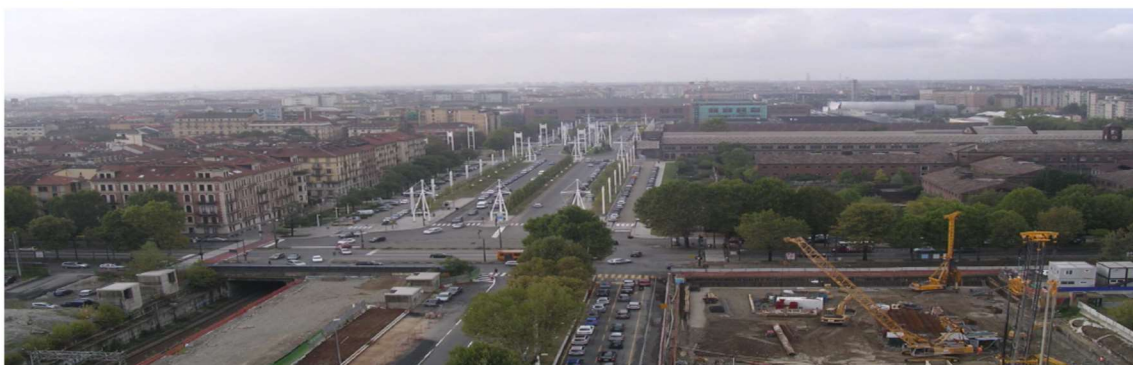
Figura 9: Panoramica sul viale della Spina angolo corso Vittorio Emanuele II. Sulla destra sono visibili il cantiere del nuovo grattacielo Intesa San Paolo, le Nuove, le officine OGR e il raddoppio del Politecnico (immagine del 2010).
