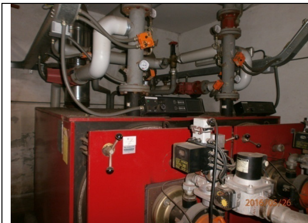
Uno dei generatori esistenti
