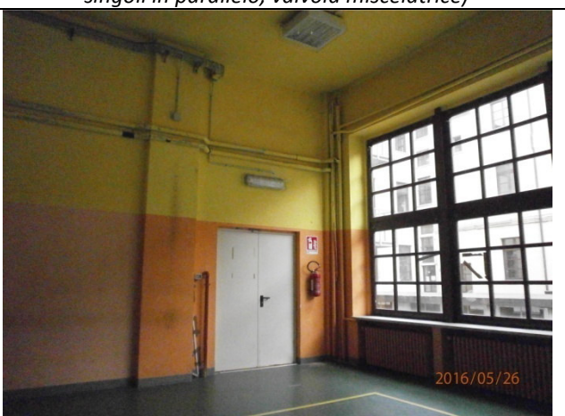
Distribuzione idronica con tubazioni a vista nel locale palestra
