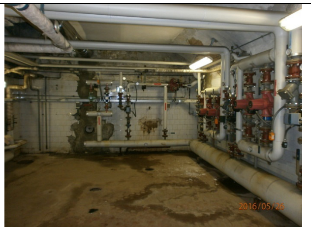
Vista su distribuzione (in locale dedicato)
