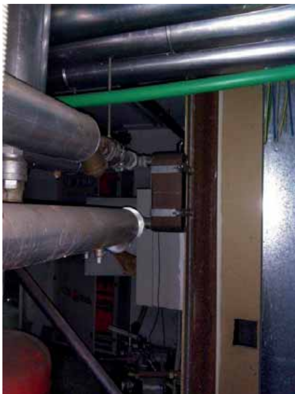
Figura 14 - Dotazioni impiantistiche in disuso
