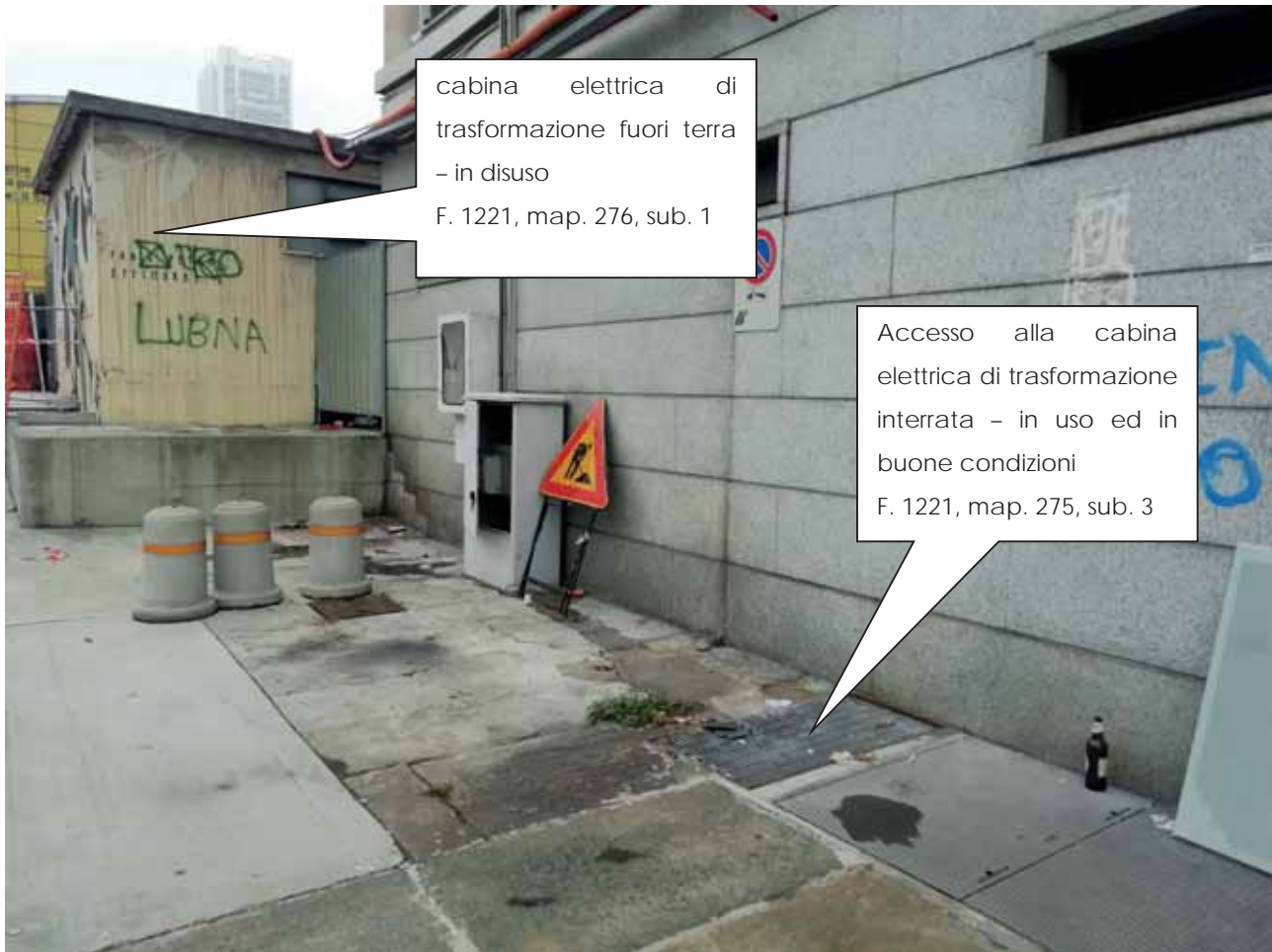
Figura 18- Cabine elettriche presenti nel sito
