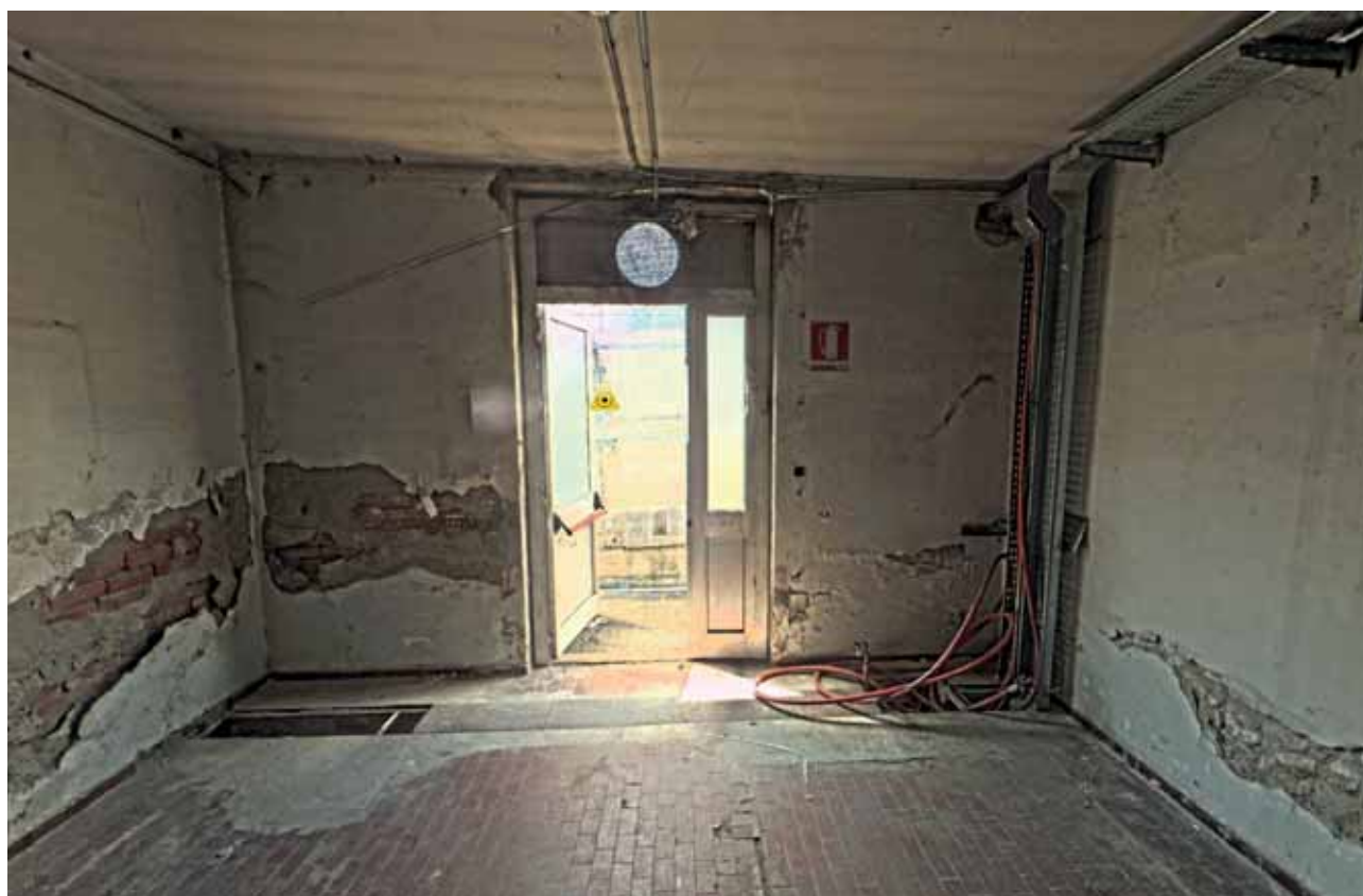
- Cabina elettrica al pianterreno -
