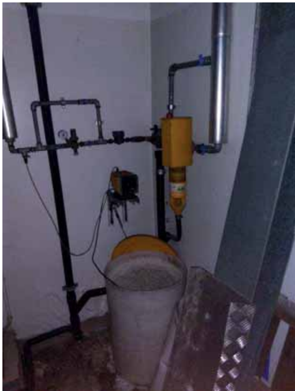
Figura 15 – Dotazioni impiantistiche in disuso
