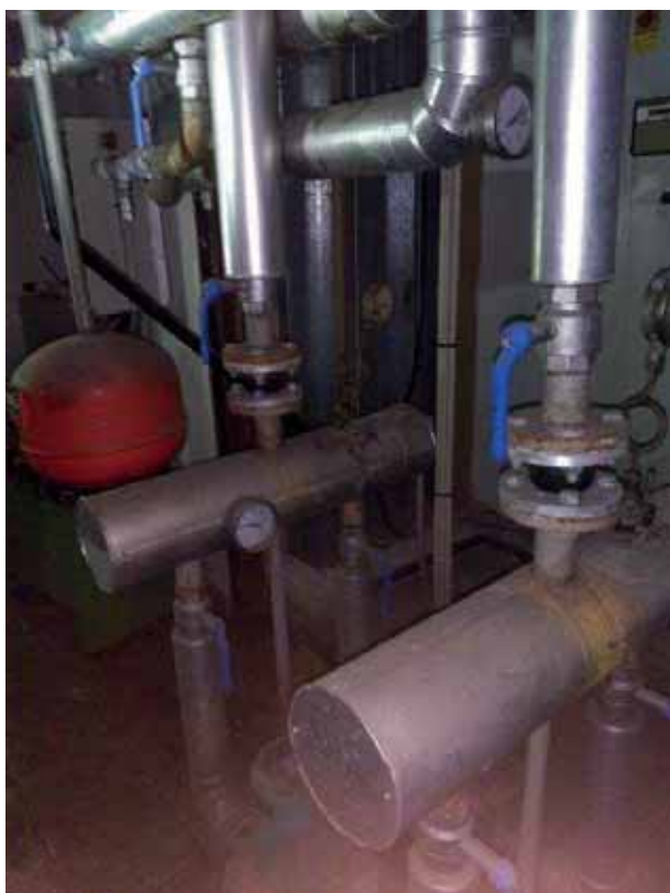
Figura 16 – Dotazioni impiantistiche in disuso
