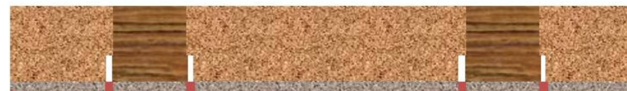
3 - Dopo la sigillatura con materiale elastico verniciabile per consentire la reintegrazione della pellicola pittorica
