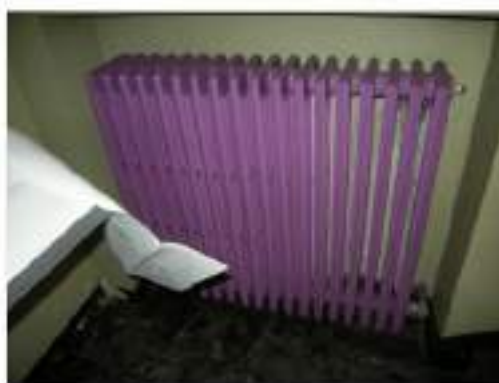
Radiatore presente nell'edificio
