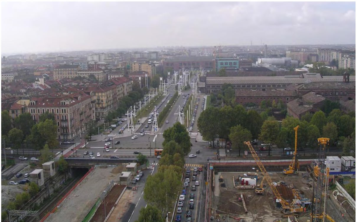
Figura 31. Panoramica sul viale della Spina angolo corso Vittorio Emanuele II. Sulla destra sono visibili il cantiere del nuovo grattacielo Intesa SanPaolo, le Nuove, le officine OGR e il raddoppio del Politecnico.
