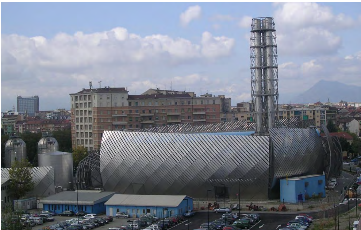
Figura 29. Centrale termica, corso Ferrucci. Una delle moderne infrastrutture di servizio localizzate sul corso.
