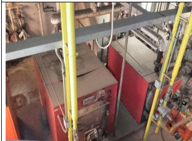
Generatori di calore
