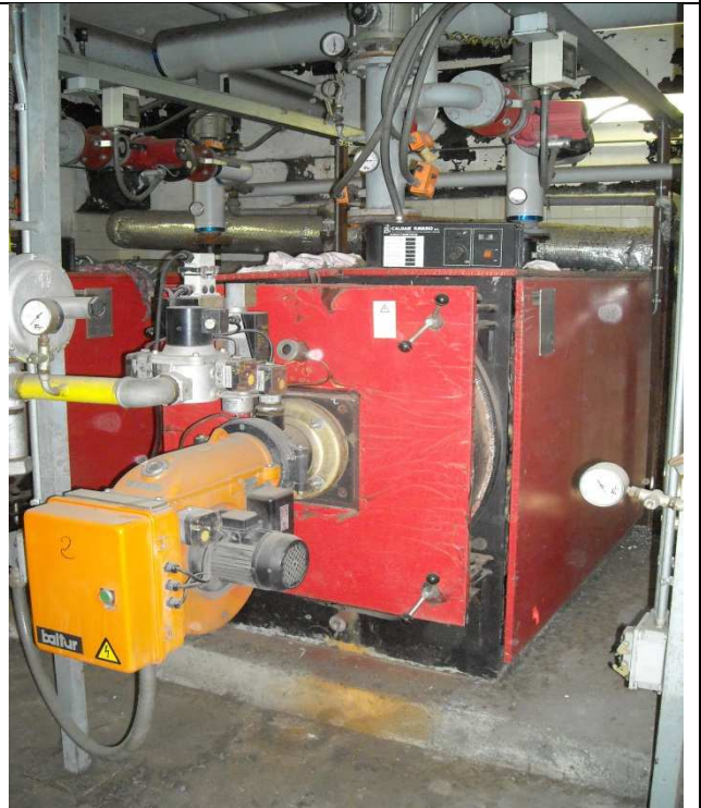
generatore di calore 2
