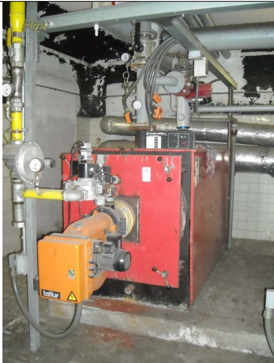
generatore di calore 1
