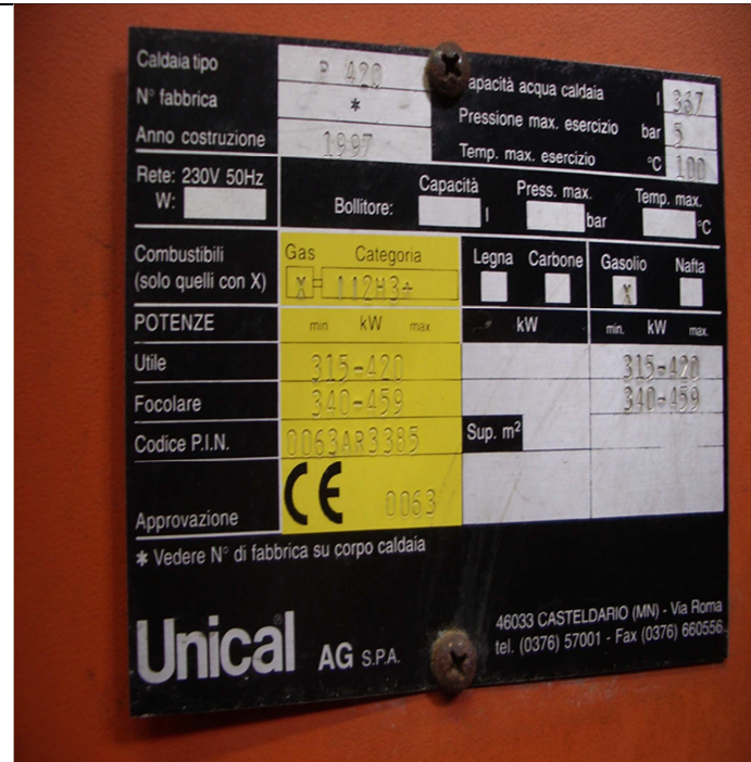
Targa generatore di calore
