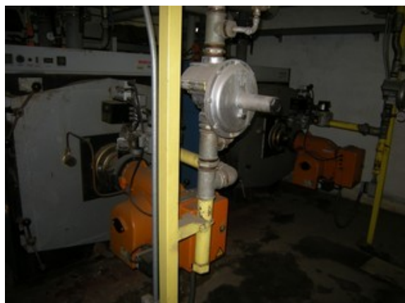
Generatori di calore
