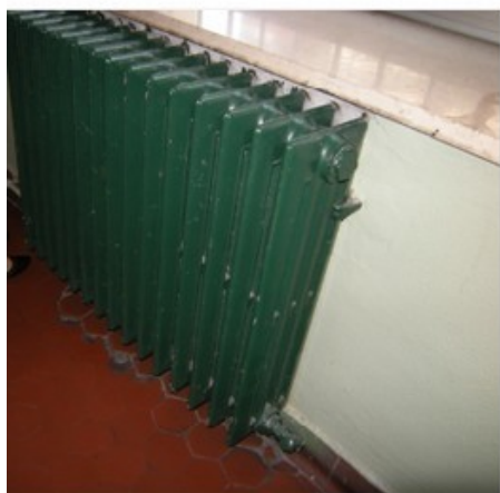
Radiatore complesso scolastico
