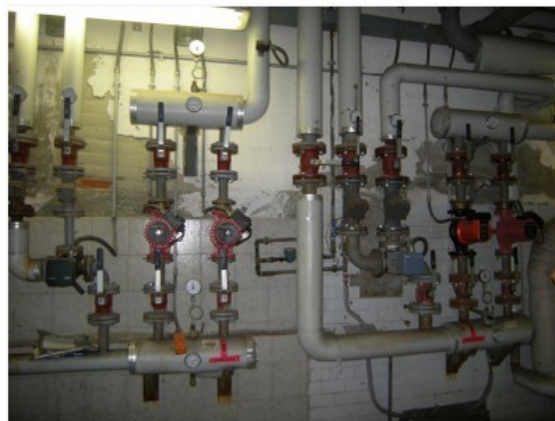
Pompe circuito secondario
