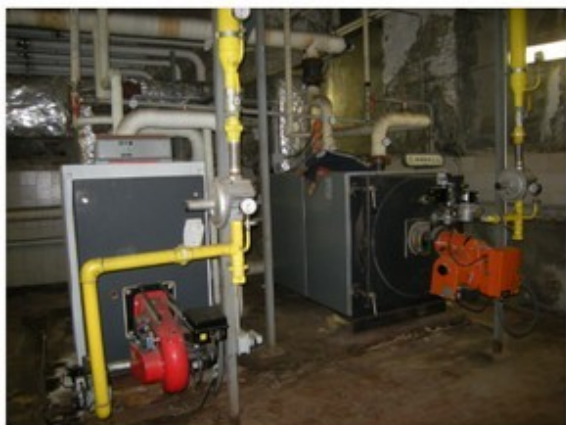
Generatori di calore
