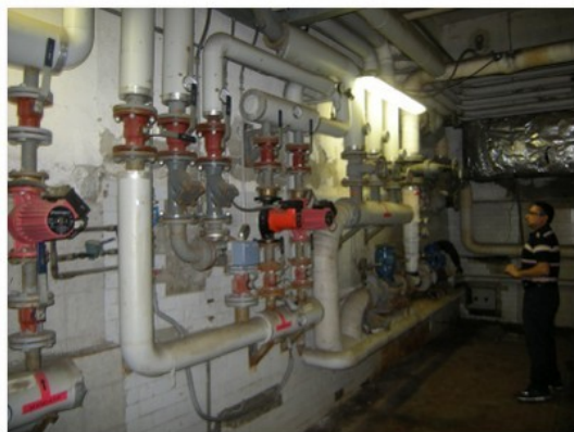
Pompe circuito secondario
