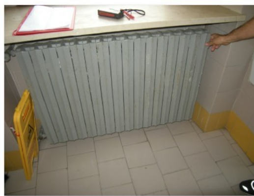
Radiatore presente nel complesso
