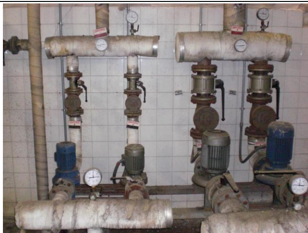
Pompe di distribuzione
