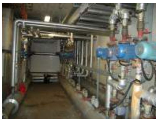
In alto le fotografie delle 3 caldaie; in basso le pompe circuito secondario
