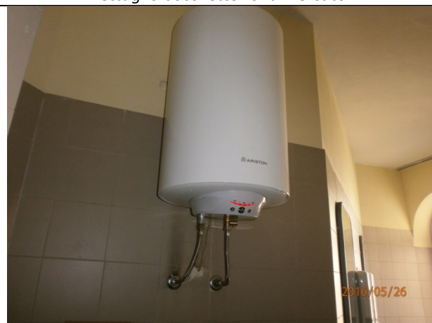
Boiler elettrico per ACS zona uffici
