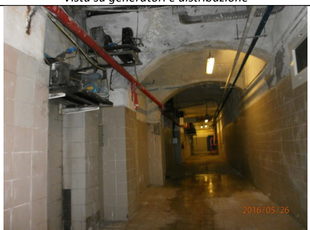
Dettaglio su distribuzione corridoio celle frigorifere
