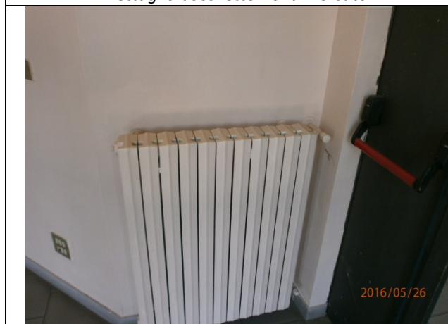
Radiatore tipo zona uffici
