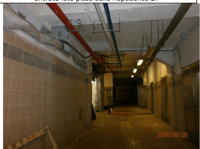
Corridoio celle frigorifere
