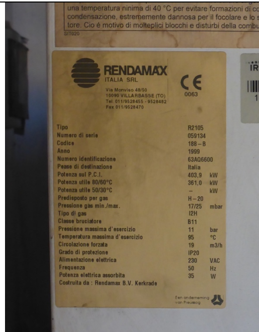
Targa generatore di calore
