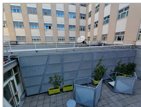
Foto 12 Esterno, baraccatura in pannelli di lamiera stirata da modificare
