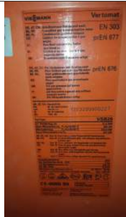
Targa generatore di calore
