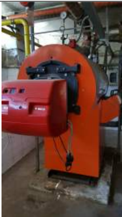
Generatore di calore esistente
