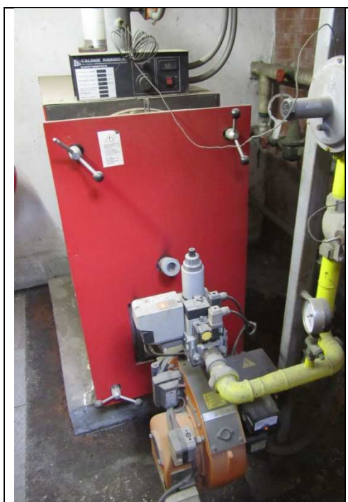
Foto generatore di calore
