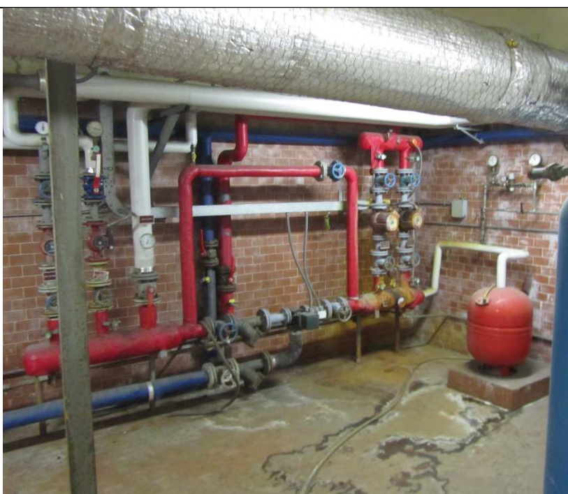
Foto gruppi di pompaggio
