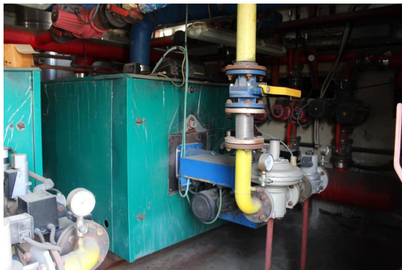
Figura 16 – Caldaie a gas naturale per la climatizzazione invernale
