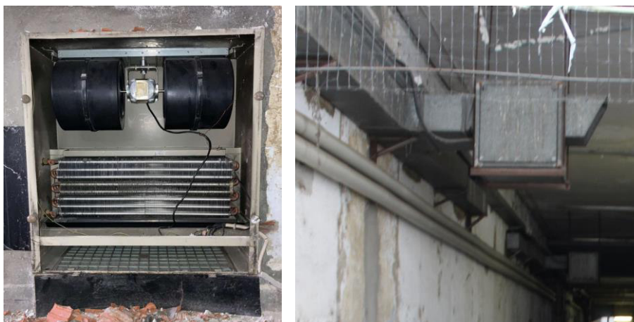
Figura 20 – Sistema tutt’aria di climatizzazione (a sinistra si riporta la fotografia dell’interno di una delle macchine di ventilazione in cui sono visibili le batterie ad acqua collegate al sistema di generazione centralizzato)
