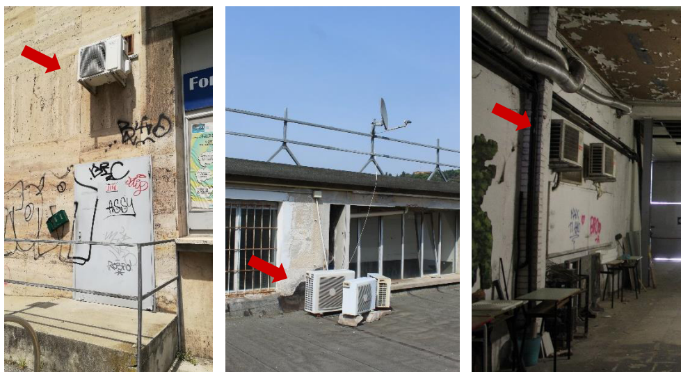
Figura 22 – Pompe di calore aria-aria per la climatizzazione di singoli locali
