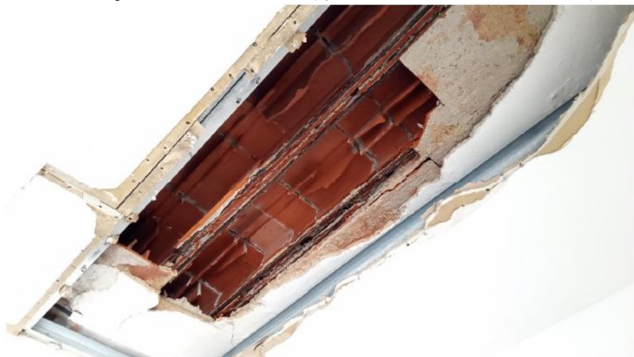
Figura 18: Maggio 2023 – cedimento plafone Piano primo Manica BCC
