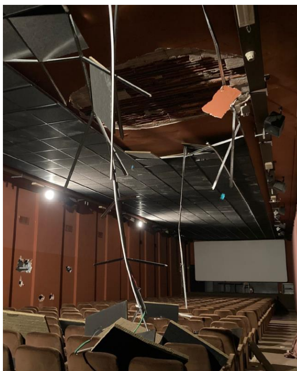
Figura 25- Gennaio 2023 – Cedimento solaio e controsoffitto in Sala Valentino (sala piccola lato Biblioteca)
