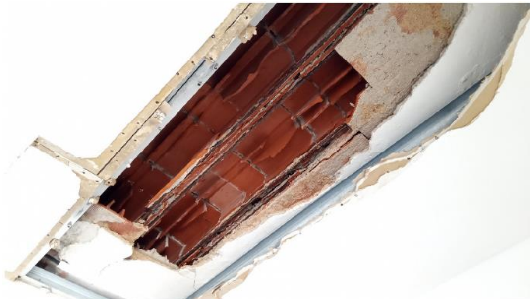
Figura 26 - Maggio 2023 – Cedimento solaio (sfondellamento) e plafone Piano Primo Manica BCC
