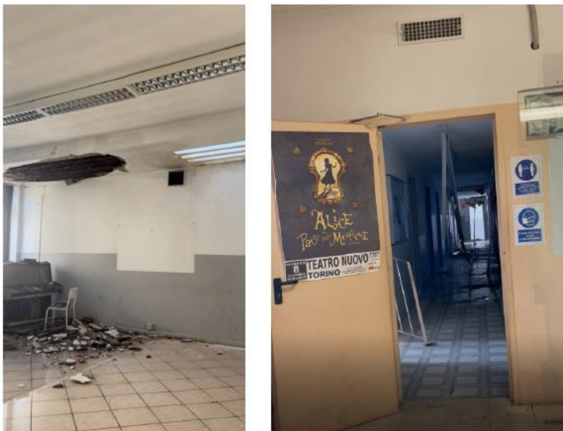
Figura 19: Maggio 2023 – cedimenti plafone Piano primo Manica BCC (saletta e corridoio)
