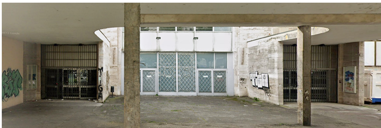
Facciata principale su corso Massimo d'Azeglio. Pensilina di copertura da restaurare.
