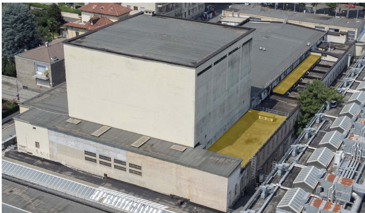
Fotografie della copertura con indicati i solai interamente demoliti
