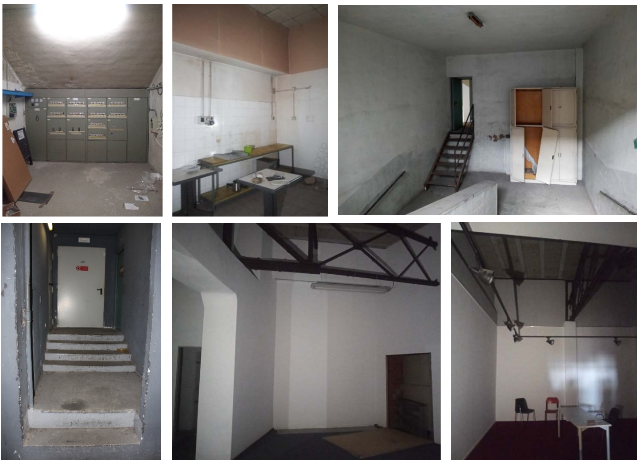
Piano terreno – Locali di servizio: quadri elettrici, angolo cucina ex-bar, locali di collegamento e sala casting
