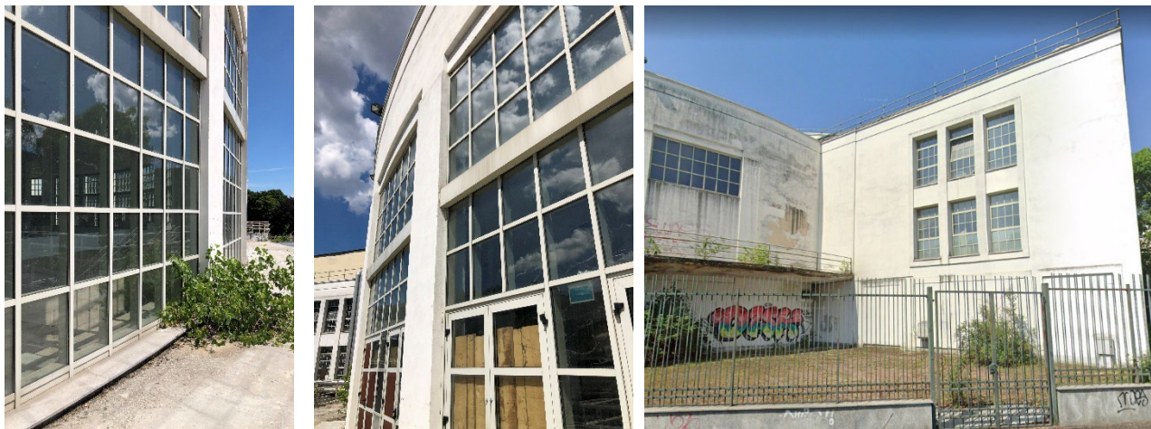
Foto dello stato di fatto: vetrata abside e facciata in cui sarà aperto il varco
