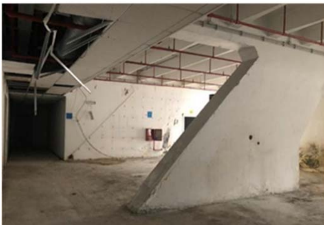
Figura 15 – Stato di fatto - viste interne del padiglione 2, rispettivamente frontone interno lato corso Massimo da balconata sud, locali piano terra sotto balconata, vano tecnico al piano terra sotto balconata
