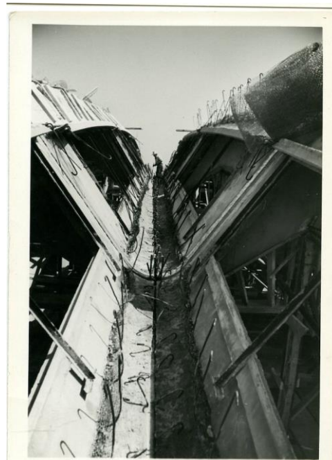
Figura 60 - Elementi della volta ondulata posati in opera, particolare dell'incavo in cui verrà eseguito il getto di calcestruzzo di collegamento degli elementi.
