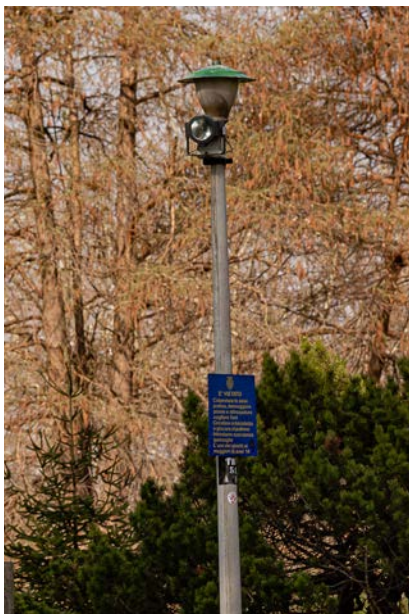
Lampione con palo in calcestruzzo
