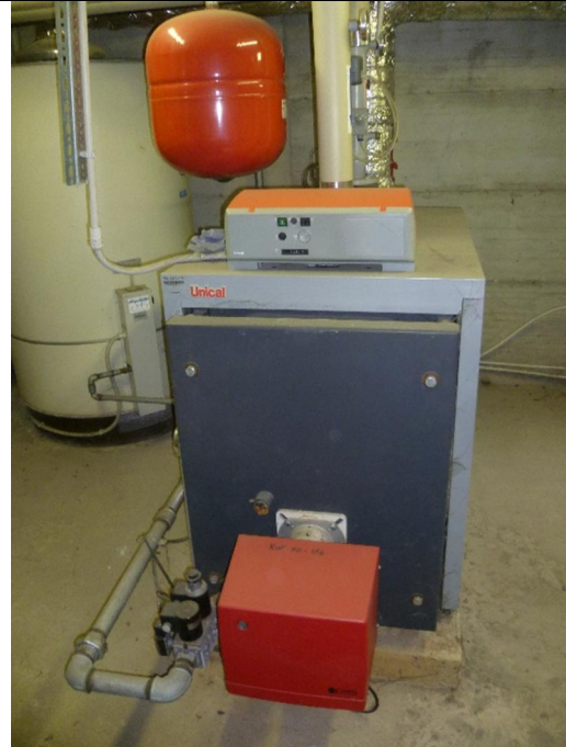
Generatore di calore
