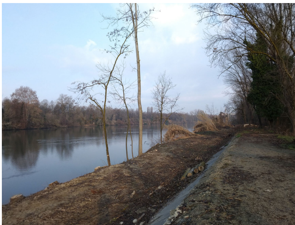
situazione dell'argine del Po a seguito dell'intervento selvicolturale per il miglioramento della sicurezza idraulica Si può notare la presenza di formazioni arboreo-arbustive non gestite che costituiscono importanti rifugi per l'avifauna presente
