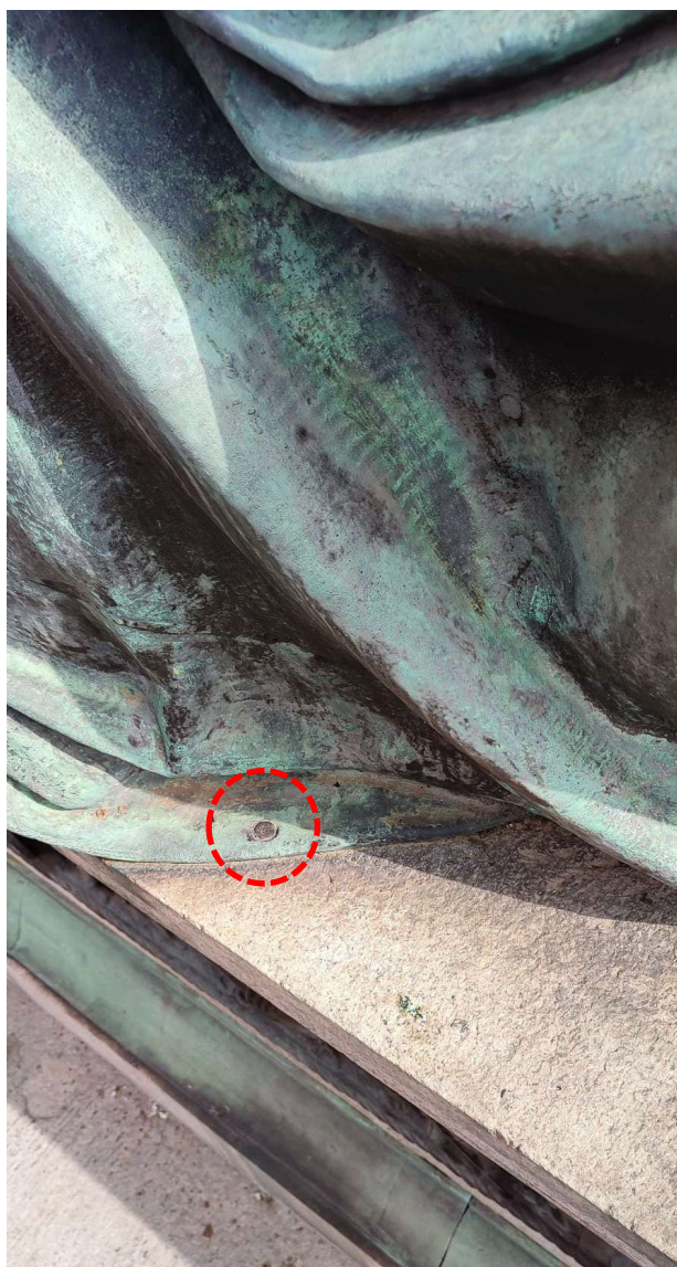
Particolare delle figure allegoriche in bronzo: sistema di ancoraggio al supporto lapideo con viti
