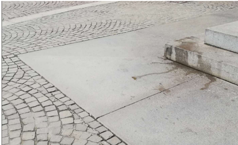
Particolare di danno provocato da deiezione animale
