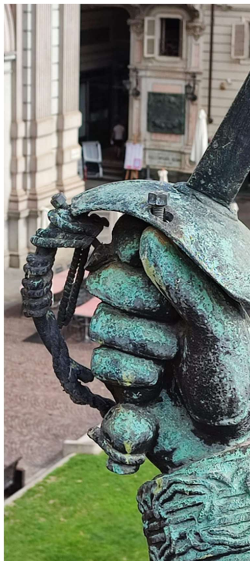
Frattura dell'elsa della spada con viti che tengono in posizione le parti distaccate
