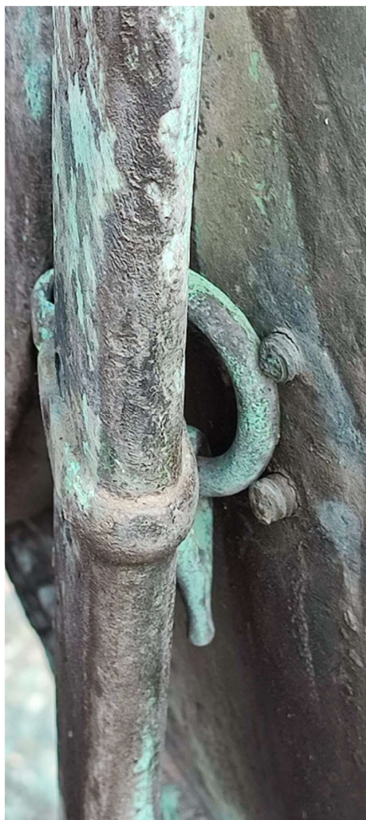
Corrosione e formazione di incrostazioni
