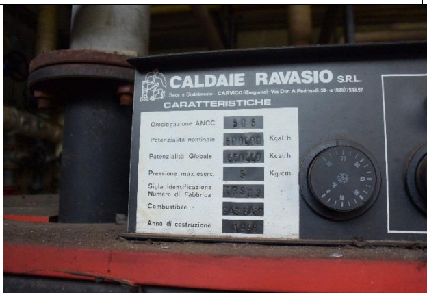
Targa generatore di calore
