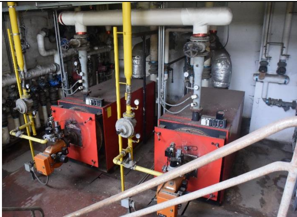
Generatori di calore
