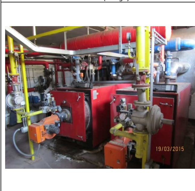
Generatori di calore (CT Deledda)
