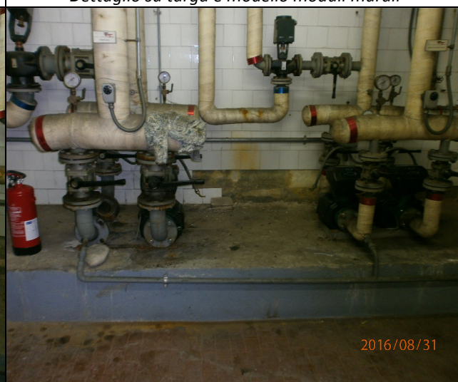
Impianto di distribuzione
