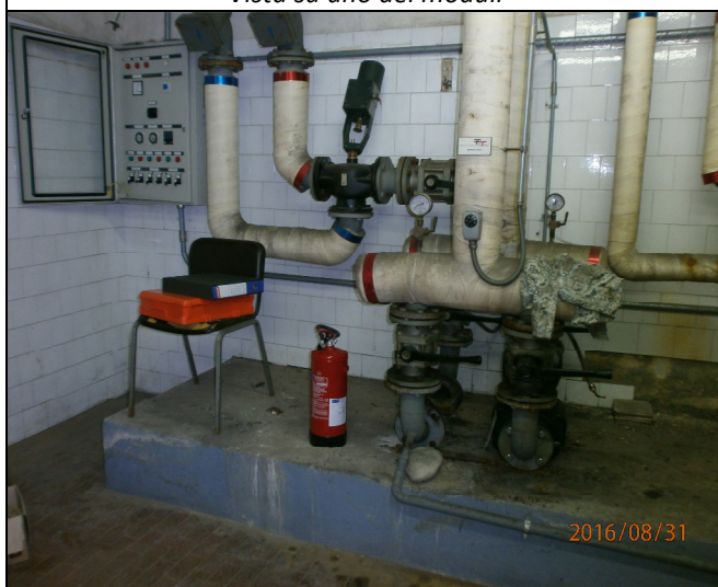
Impianto di distribuzione
