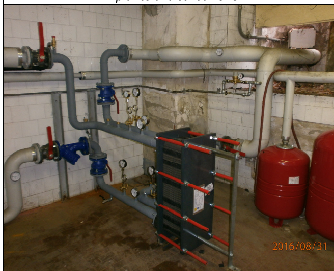
Scambiatore intermedio tra generatori e distribuzione
