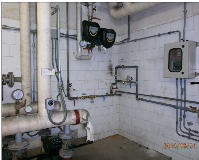
Impianto di distribuzione
