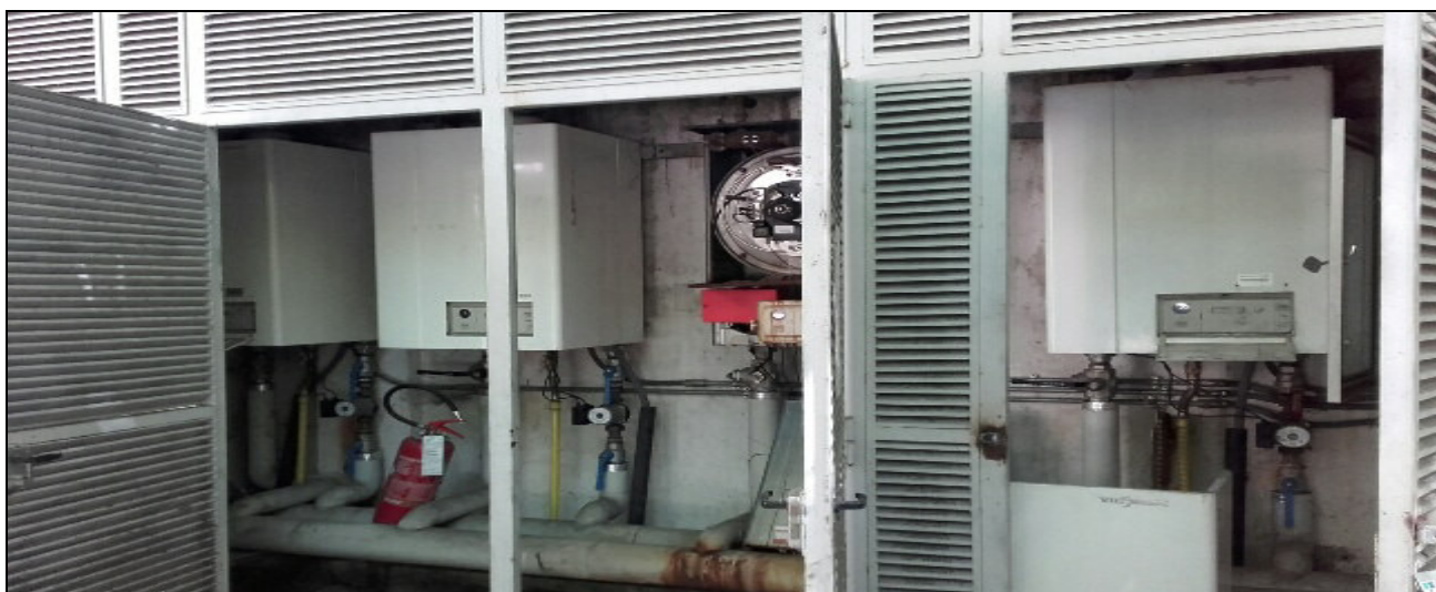
Centrale termica o del locale di installazione (foto di insieme)
