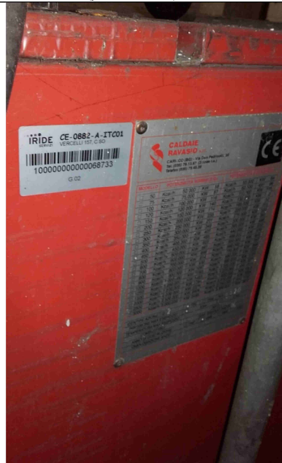
Targa generatore di calore 2
