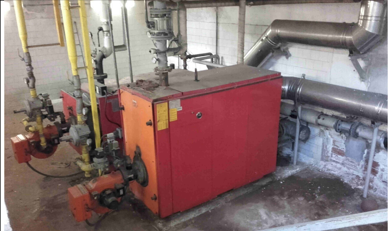
Foto Centrale termica o del locale di installazione (foto di insieme)
