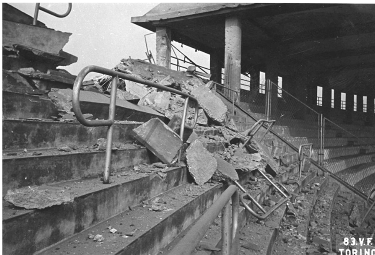
Figura 20. Danni causati dalla dispersione delle bombe sganciate nell'area del nodo ferroviario Torino-Smistamento: lo Stadio "Benito Mussolini" (oggi Stadio Olimpico), prossimo alla progettata stazione Santa Rita e a circa 1000 metri di distanza dal nodo ferroviario Torino-Smistamento, obiettivo dell'incursione, è colpito il 17 agosto 1943 (Archivio Storico della Città di Torino/Archivio Storico Vigili del Fuoco)
