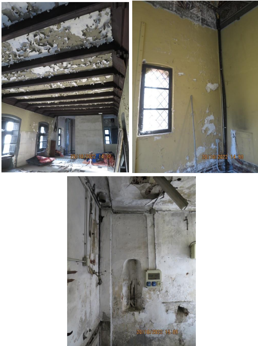
Fotografie rappresentative dei degradi presenti sui prospetti interni degli edifici.
