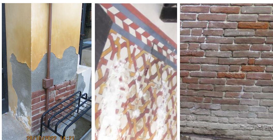
Fotografie rappresentative dei degradi presenti sui prospetti esterni degli edifici.
