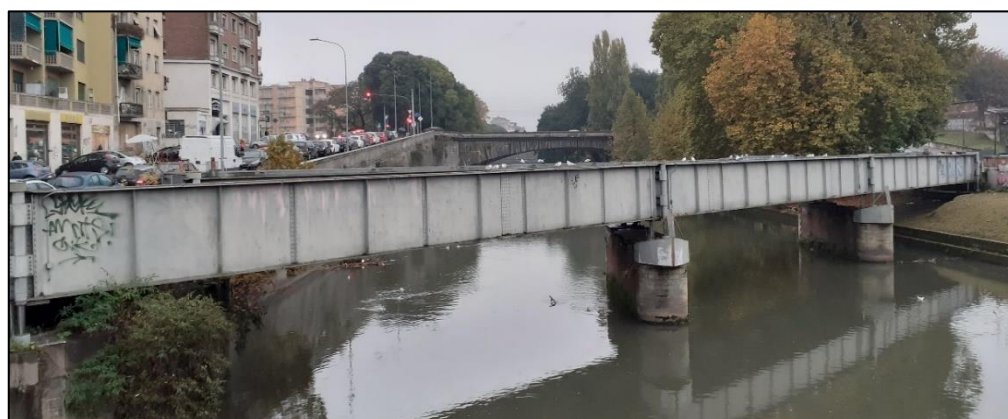
Figura 14 – Ponte tramviario ubicato a valle del ponte Carpanini parzialmente sollevato
