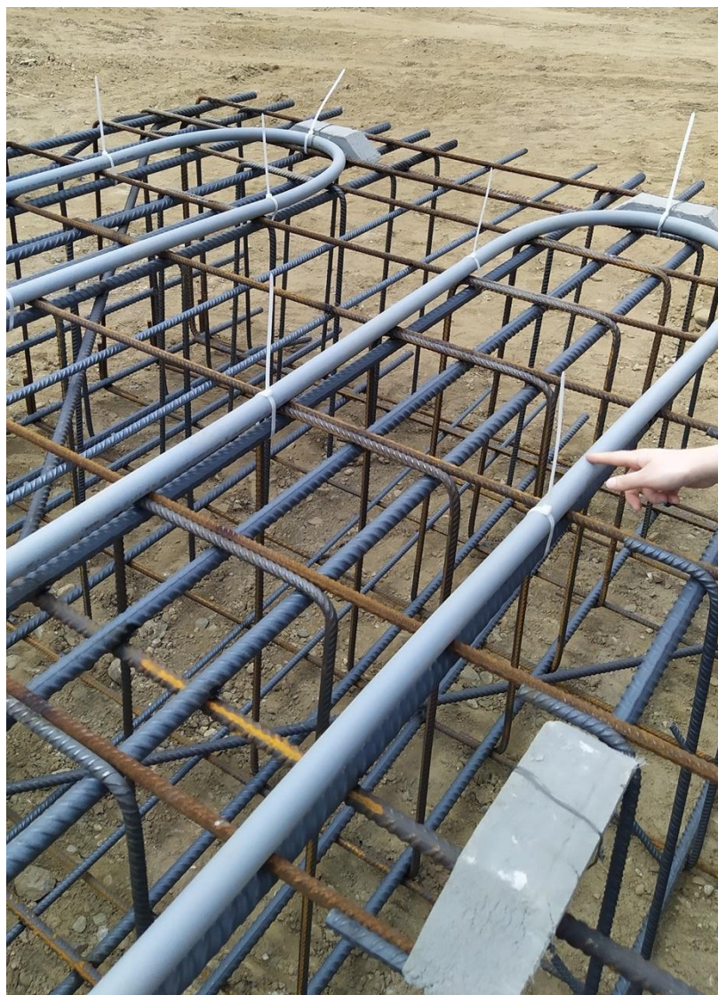
Figura 8. Particolare della disposizione delle tubazioni di scambio termico all'interno dell'armatura di un diaframma energetico.
