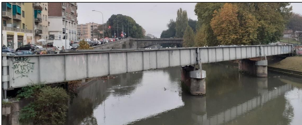
Figura 119. Ponte tramviario ubicato a valle del ponte Carpanini parzialmente sollevato
