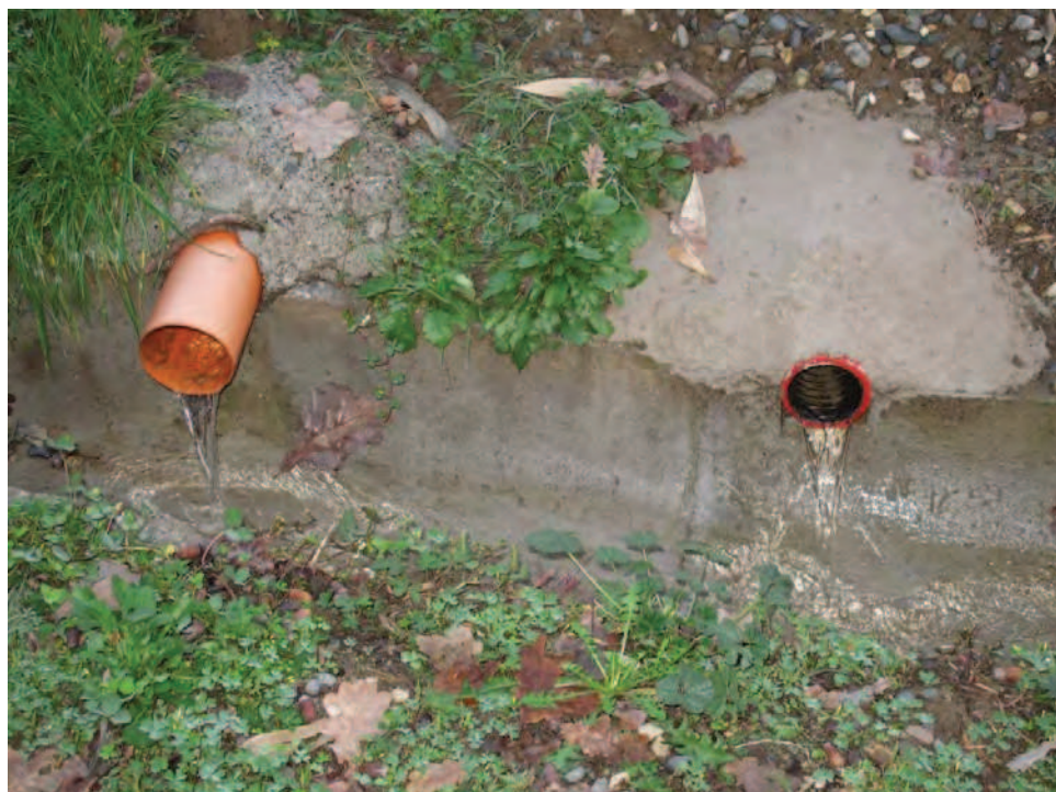
Collettore di drenaggio D-E
