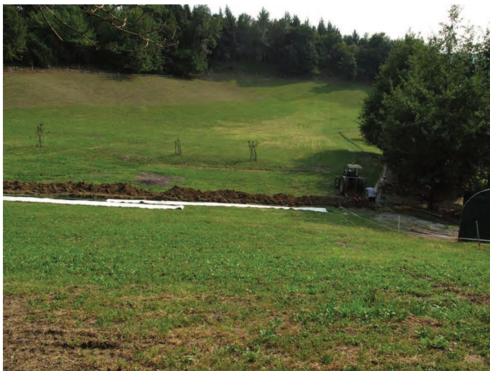
Collettore di drenaggio D-E
